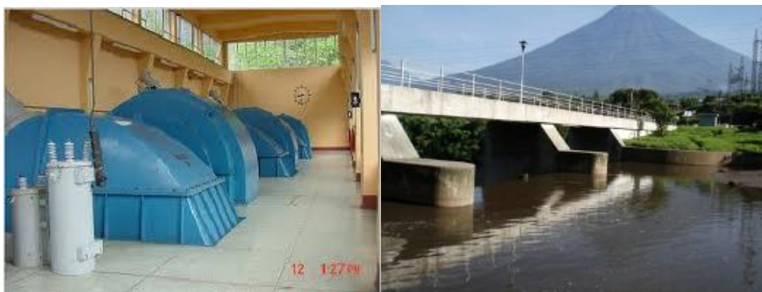
Fotografías donde se observan la casa de máquinas y represa ubicada en el Lago de Amatitlán de la hidroeléctrica Jurún Marinalá.
