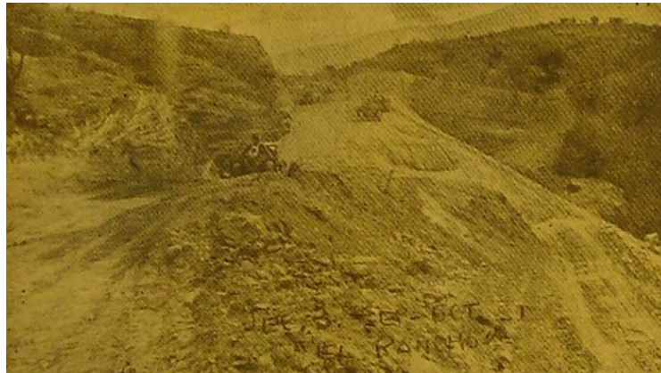
Imagen 4 Apertura de la brecha entre Sunzapote y Teculután. Sector 4 Ruta al Atlántico. Evidencia la maquinaria que se estaba utilizando.
